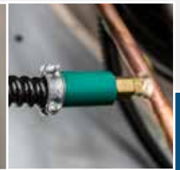
Control de alta presión
