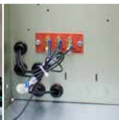
Tablilla de conexiones
