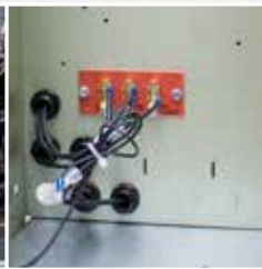
Tablilla de conexiones
